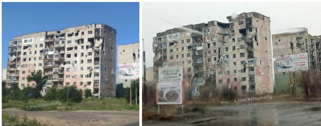
Рис. 4. Будинок по вул. Вілосова, 43: а – серпень 2022 р.; б – березень 2023 р. (за даними https://t.me/severodonetsk/11670 )
