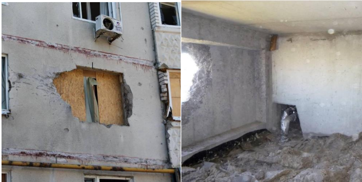
Рисунок 1. Ушкодження конструкцій внаслідок влучення снарядів
