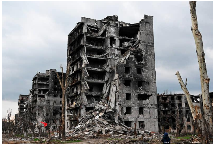
Рисунок 2. Зовнішній вигляд зруйнованого будинку
