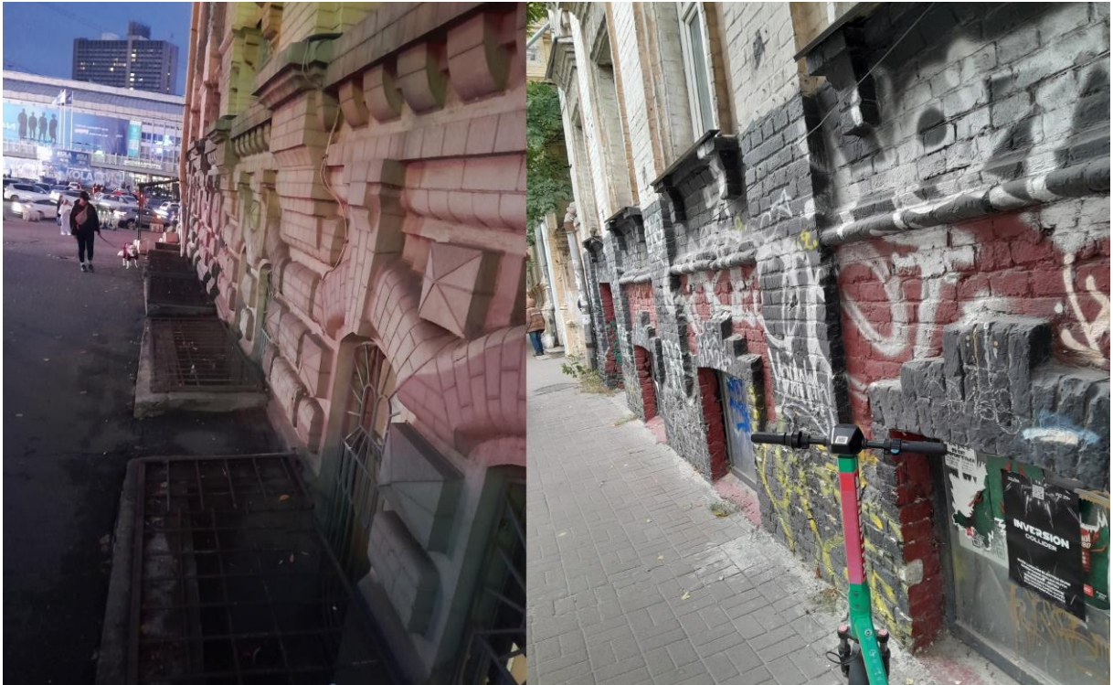
Рисунок 1. Фото занедбаних напівпідвальних приміщень історичних будівель м. Києва.
